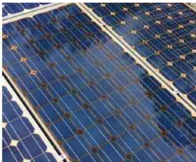
38. ábra. Elszíneződött napelemmodul.
