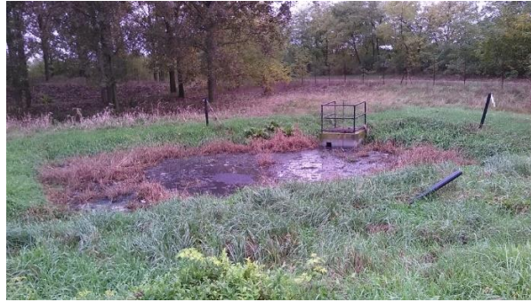
8. ábra Nagycserkesz szennyvíztisztító telep műtárgyai [saját]
