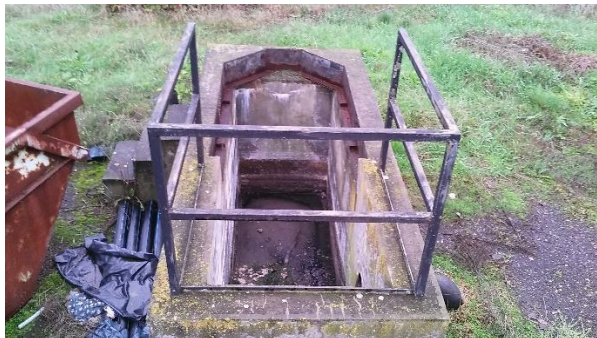
10. ábra Nagycserkesz szennyvíztisztító telep műtárgyai [saját]
