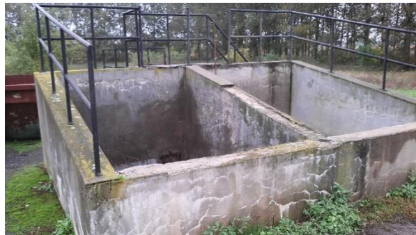
9. ábra Nagycserkesz szennyvíztisztító telep műtárgyai [saját]
